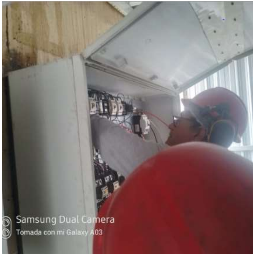
Anexo 10. Elevador de azúcar revisión del tablero eléctrico.
