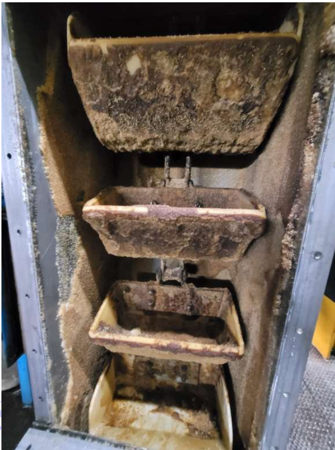
Anexo 7. Elevador de azúcar cangilones deteriorados.
